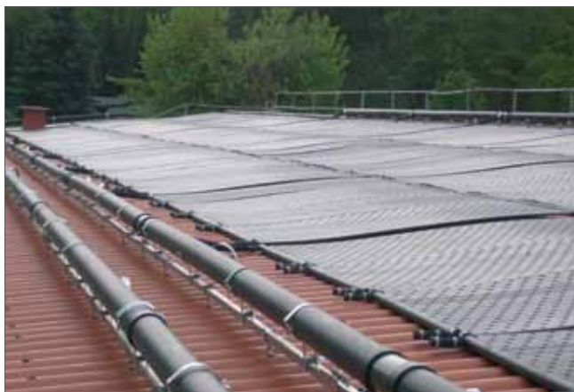
Installation sur toit plat
